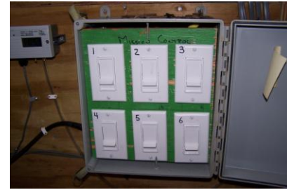
Variable Fan Controls
